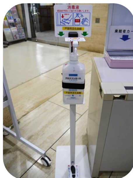
足踏み式消毒ポンプスタンド設置
